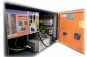
Blick in einen Schweißkoffer
