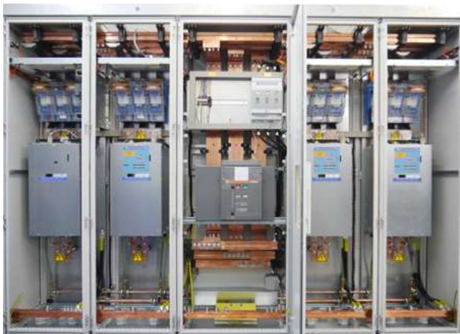
Abb. 8-2 Sonderanlage: maximaler Schweißstrom 300kA System SiniusHWI 3460 Master mit drei Slave-Invertern
